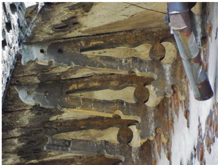
A Csuka-villa merészen előreugró párkányát alátámasztó karcsú vasbeton konzolok. Jellegetes Medgyaszay szerkezet. A szerző felvétele 2020. április 12-én.
